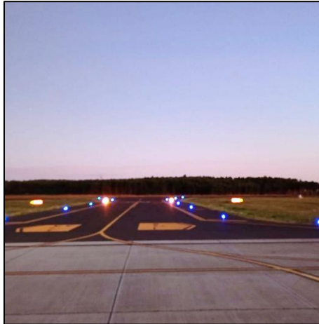
Balizamiento de calles de rodaje
