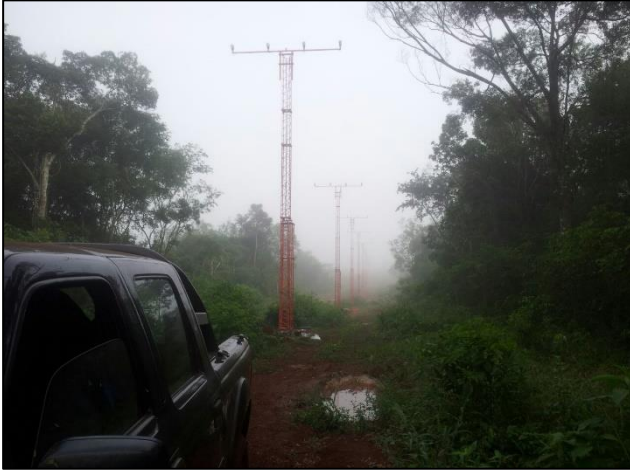
Instalación de luces de Aproximación sobre mástiles
