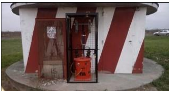
Instalación de transformador con jaula de seguridad para alimentación de antena VOR
