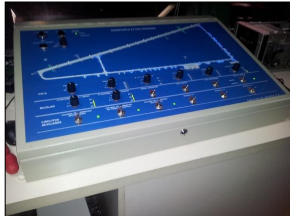
Pupitre de comando de balizamiento en torre de Control
