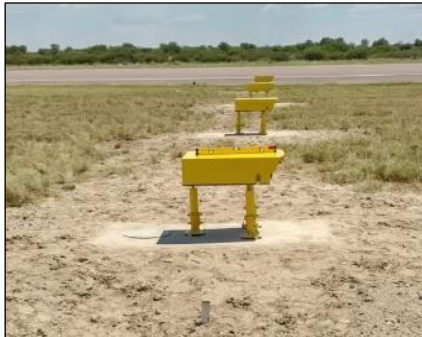
Luces PAPI instaladas
