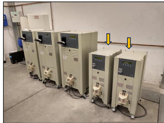
Reguladores de Corriente Constante Instalados
