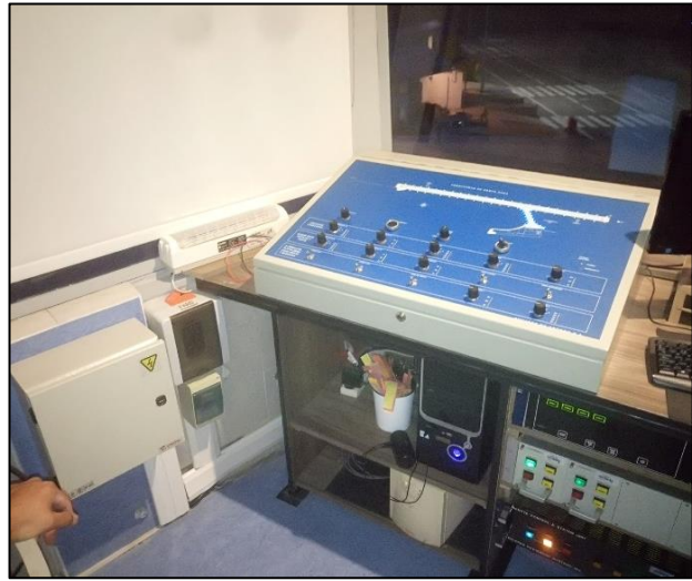
Sistema de Control
