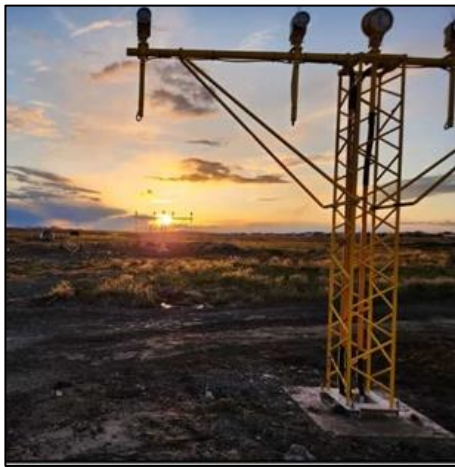
Base y mástil de luces ALS
