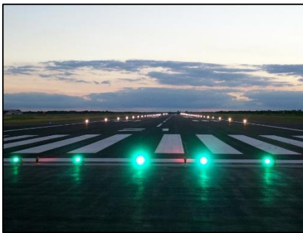
Balizamiento de Pista
