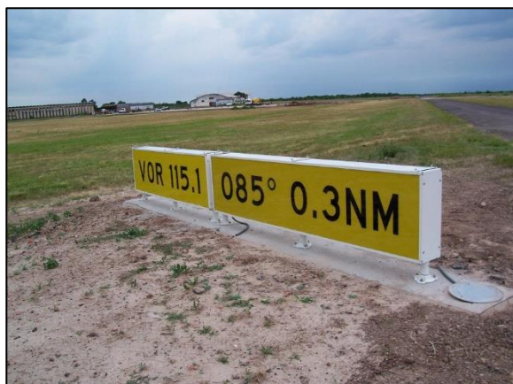
Letrero de VOR instalado
