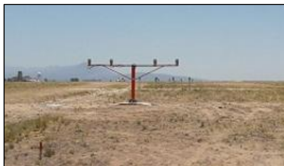
Barra de luces de Aproximación elevada
