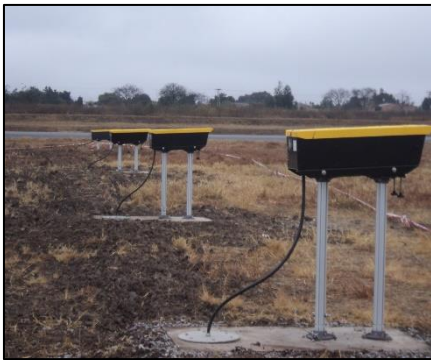
Luces de PAPI instaladas
