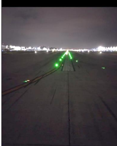
Habilitación de luces en eje de rodaje de dársena de giro en Cab.31
