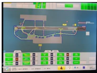
Sistema de Control de Balizamiento
