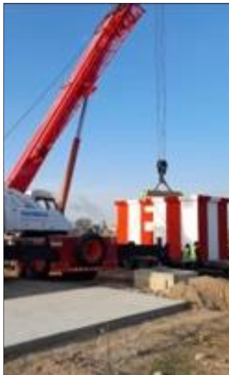
Emplazamiento Ed. Premoldeado de SET Balizamiento
