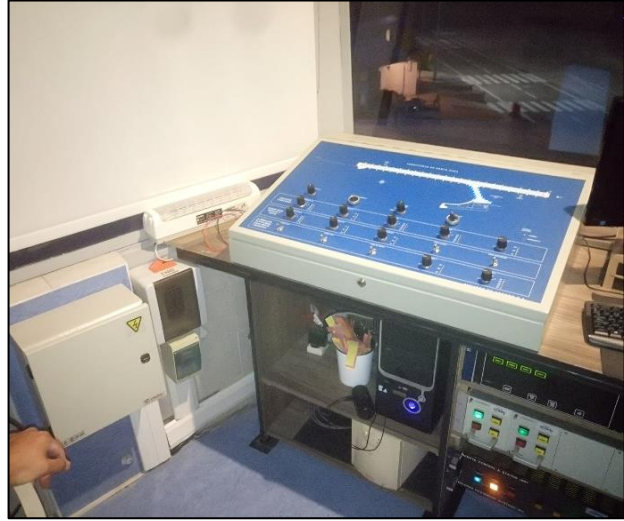
Sistema de Control
