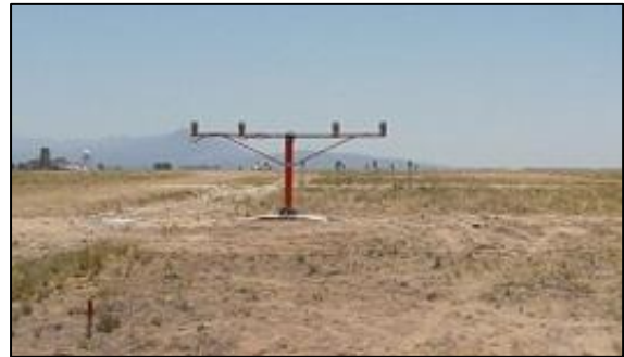
Barra de luces de Aproximación elevada
