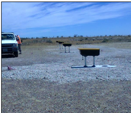
Instalación de Luces de PAPI
