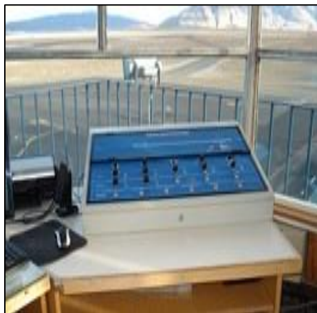
Pupitre de Control Balizamiento
