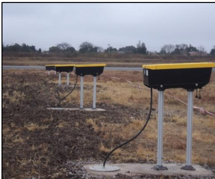
Luces de PAPI instaladas
