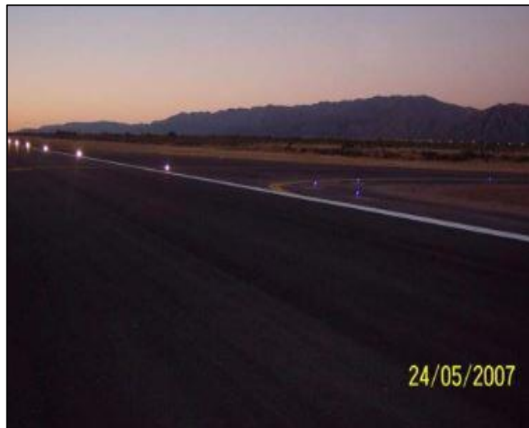
Luces de borde de pista y rodaje
