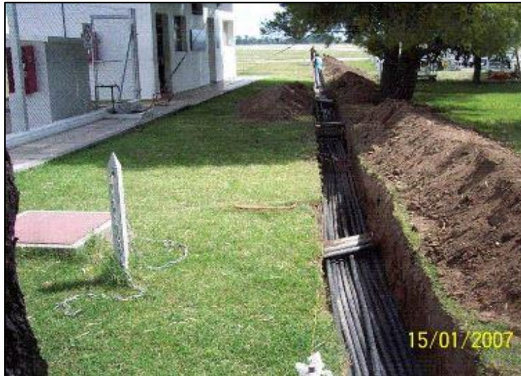
Troncal de balizamiento
