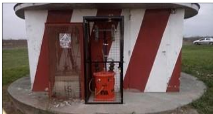
Instalación de transformador con jaula de seguridad para alimentación de antena VOR
